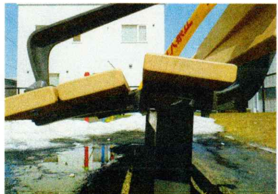
公園のベンチが雪の重みで破損してしまった状況
